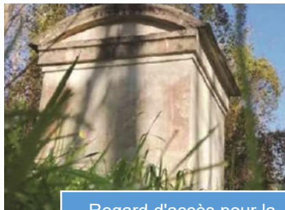
Regard d'accès pour la maintenance
